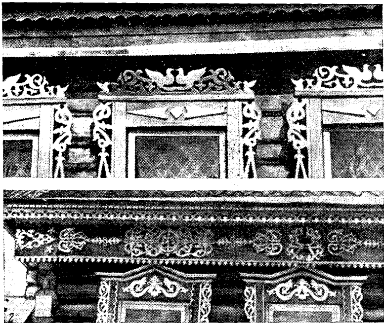
Рис. 6. Пропильная резьба (плоская пропиловка): 1 — фрагмент из села Подберезье Татарской АССР; 2 — деталь резьбы из с. Сюксеево Татарской АССР
