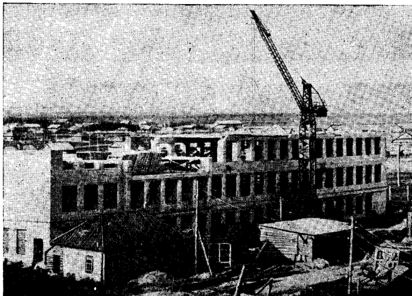
Рис. 4. Строящееся здание новой школы в с. Старо-Алейке Змеиногорского района, 1965 г. (рядом дом, в котором раньше помещалась церковно-приходская школа).
